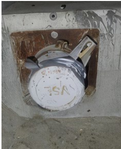
Photos des capots de protection des ancrages d'extrémité des câbles de précontrainte
