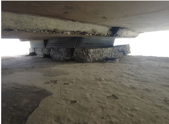
Pile 24 : bossages bétons éclatés, déformations et gerçures des appareils d'appuis
