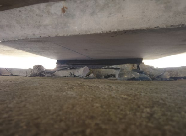
Pile 6 : bossages éclatés, gerçures appareils d'appui
