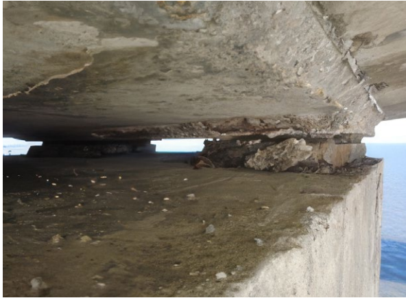
Pile 27 : bossages éclatés
